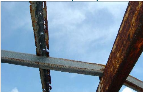
Corrosion of top hat batten
